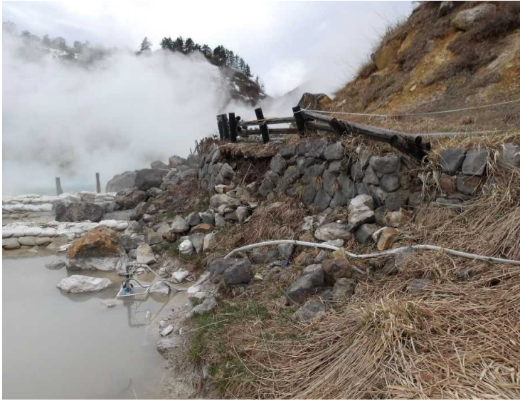
【歩道（木柵工・石積工）】 劣化・損壊状況
