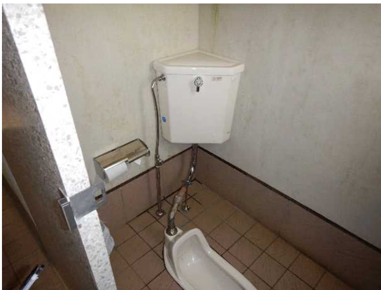
配管部が老朽化し漏水している。 トイレ改修に合わせ洋式化
