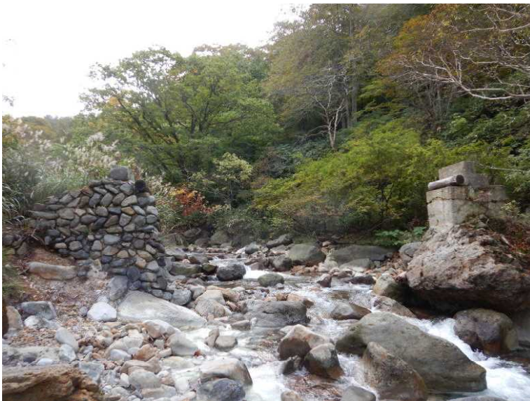
黒湯 1 号橋 （上部工が崩落・消失）
