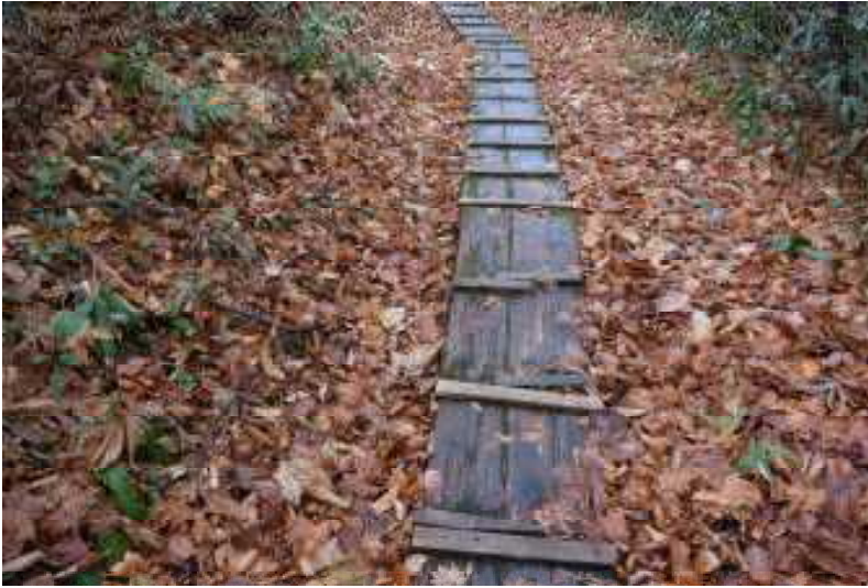
木道の老朽化の状況
