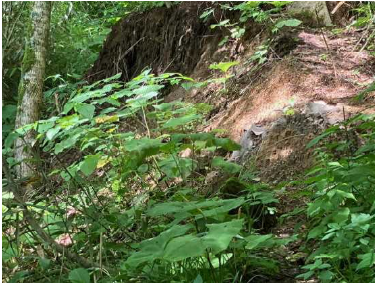
歩道の崩落状況
