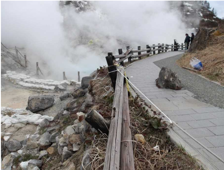
【歩道（木柵工・石積工）】 劣化・損壊状況
