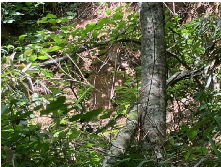
歩道の崩落状況
