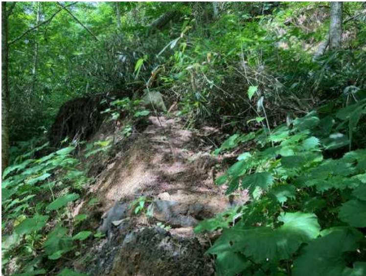
歩道の崩落状況
