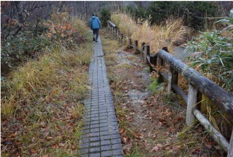
防護柵の老朽化の状況
