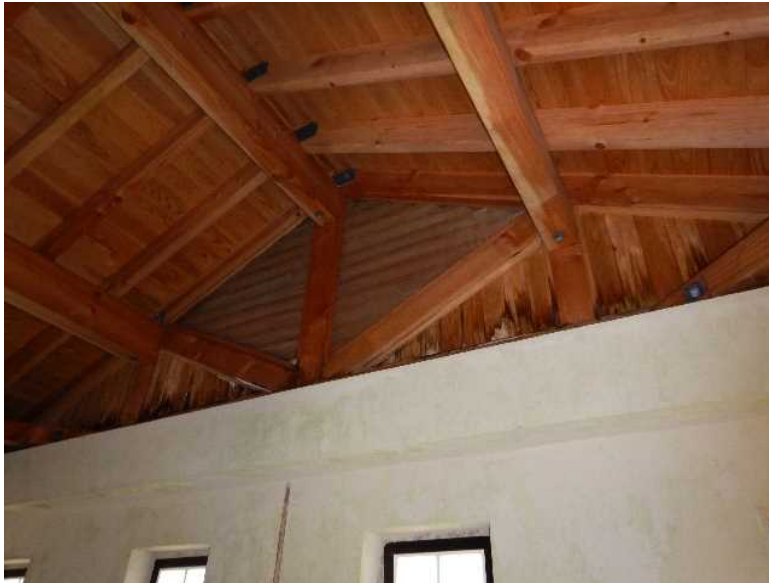
内装の老朽化
