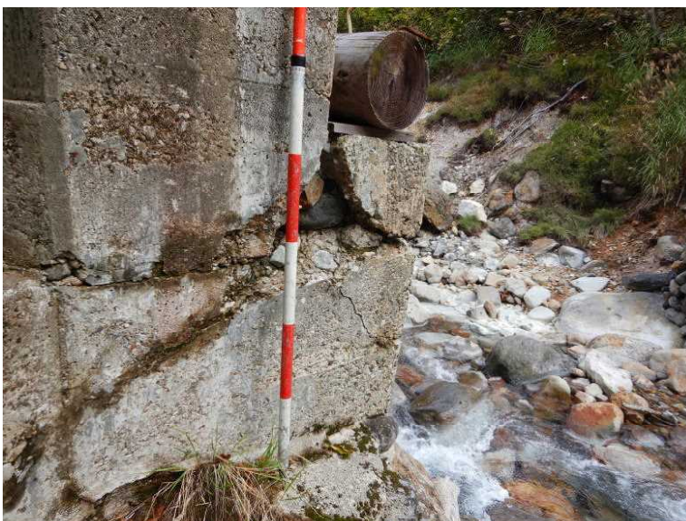
黒湯 1 号橋 （橋台の劣化・破損状況）
