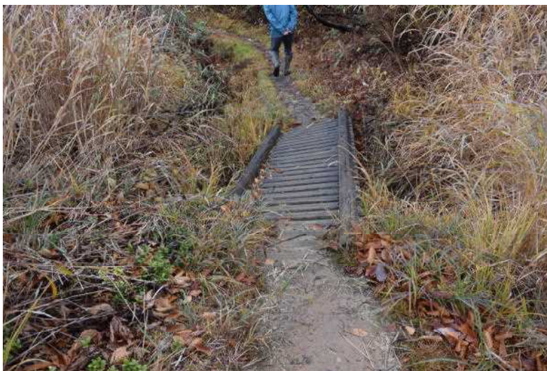
木橋が老朽化により傾いている。
