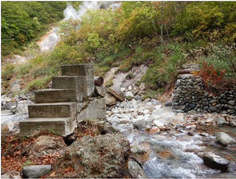
黒湯 1 号橋 （上部工が崩落・消失）
